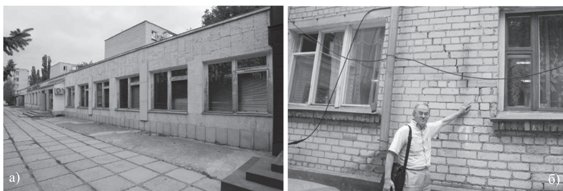
Рис. 4. Здание библиотеки в г. Буденновске по ул. Батакской, 12, 2014 г.: а) общий вид, б) наклонная трещина в центральной части (фото В. В. Сербина, 2014 г.)
