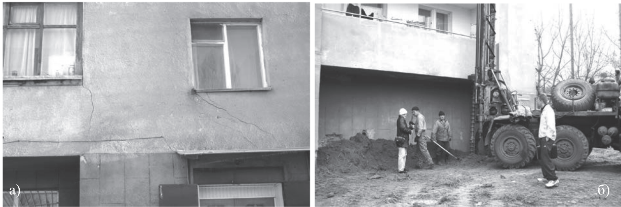
Рис. 6. Жилой дом по ул. Пушкина, 93 в г. Кисловодске: а) трещины в стенах, б) укрепление грунтовыми сваями (фото Б. Ф. Галая)
