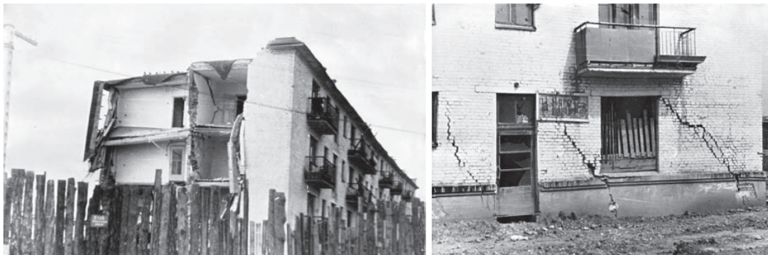
а) б) Рис. 1. Разрушение жилого дома в пос. Гарагоры ЧИ АССР: а) общий вид; б) аварийные деформации в уровне 1-го этажа (фото Б.Ф. Галая, 1972 г.)
