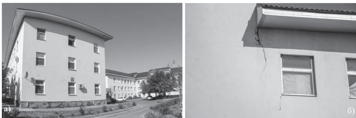
Рис. 5. Здание Буденновской центральной районной больницы: а) общий вид и б) трещины в стенах (фото В. В. Сербина, 2014 г.)
